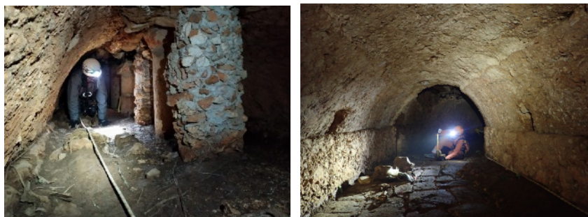
Figura 4. Cubierta del túnel sin acabado y cerca de una zona en donde ha sido reforzado debido al colapso. Columnas hechas de mampostería y piedra labrada colocadas para reforzar el colapso. Figura 5. Zona del túnel en donde se puede observar el piso original, el pretil y los nichos ubicados en los laterales del túnel que corresponden a los posibles canales de desagüe.
